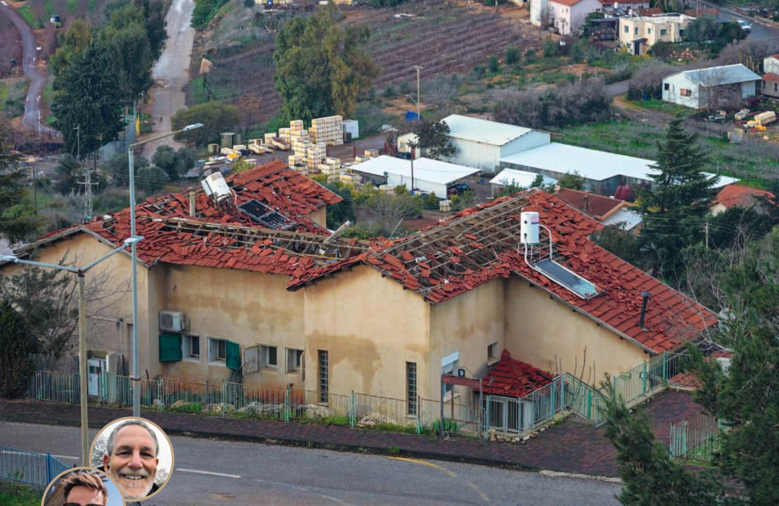
Die Schäden an Häusern und Infrastruktur nahe der libanesischen Grenze sind unübersehbar.
